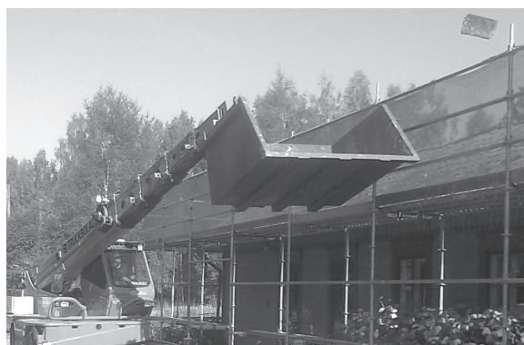
En av mängden sköra och trasiga tegelpannor i luften.
